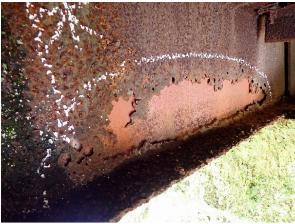
写真-2 主桁端部におけるウェブの貫通孔
